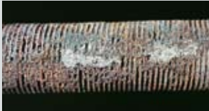
HARICI KOROZYON Hava girmesi nedeniyle.
