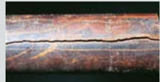
STRES ÇATLAMASI Yüksek su debisi nedeniyle oluşan dikey veya granüller arası çatlaklar.
