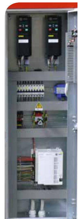
Pakket regelingen dat in de fabriek is samengesteld
