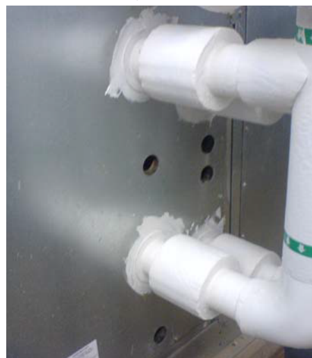
Figura 2. Orifícios do dreno e de ventilação da serpentina sem vedação.
