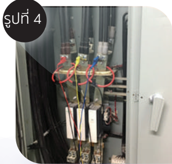
รูปที่ 4 อุปกรณ์วัดพลังงานไฟฟ้า (Power Meter)
